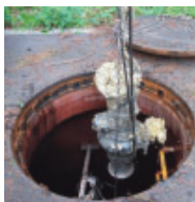
油まみれになった水中ポンプ (六郷地区)
