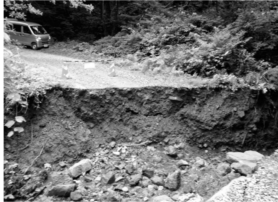
決壊により寸断された町道真昼岳線
