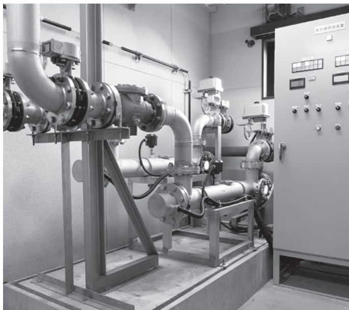
仙南中央地区浄水場の紫外線照射装置
