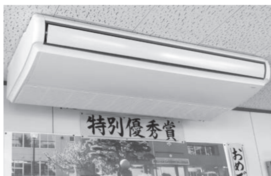
六郷小学校ホールの室内機
